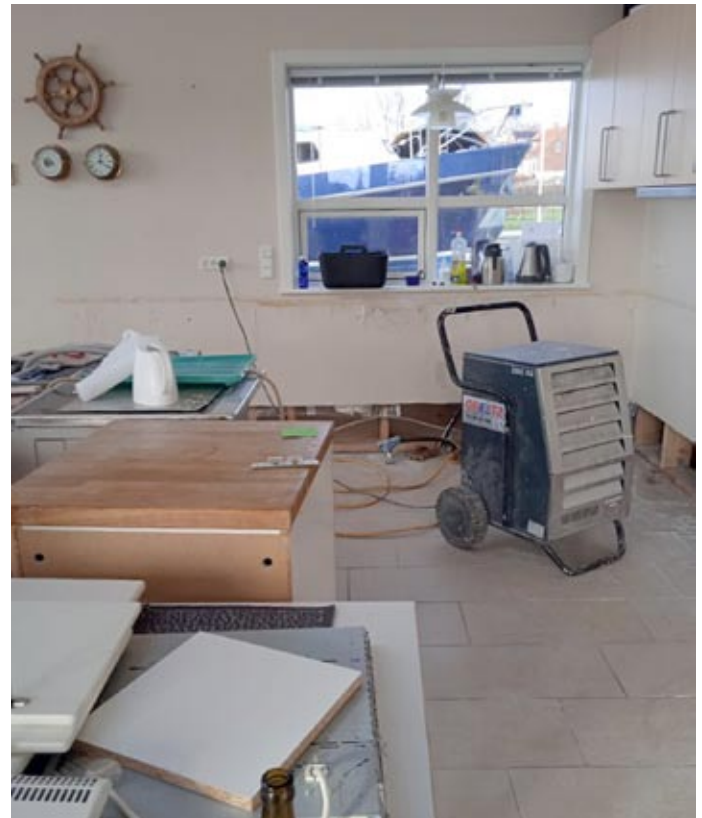
Klubhusets køkken er taget ned for at udtørre væggene, der skal genopføres med isolering, der kan tåle vand. Man kan se på billedet, hvor højt vandet har stået i bygningen. Foto: Arne Andersen
