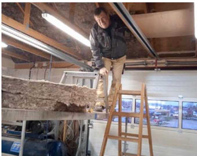
Benny Svendsen højt til vejs for at isolere tagkonstruktionen. Man ser tydeligt de nye LED-armaturer. Foto: Alex Jensen
